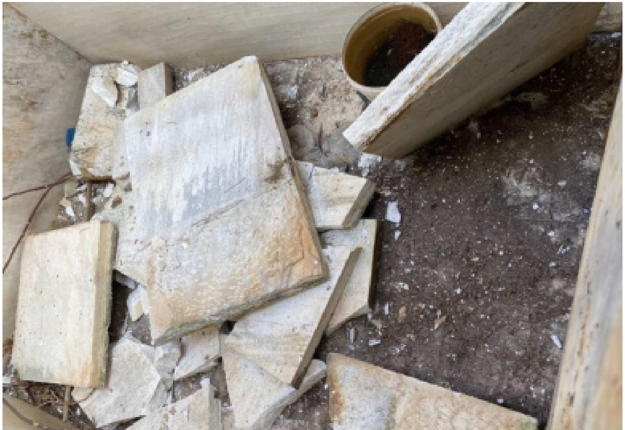
Φωτ. 22. Οι λιθόπλακες της στέγης όπως έχουν καταπέσει στο εσωτερικό του μνημείου και εμποδίζουν την κίνηση των θυρόφυλλων.
