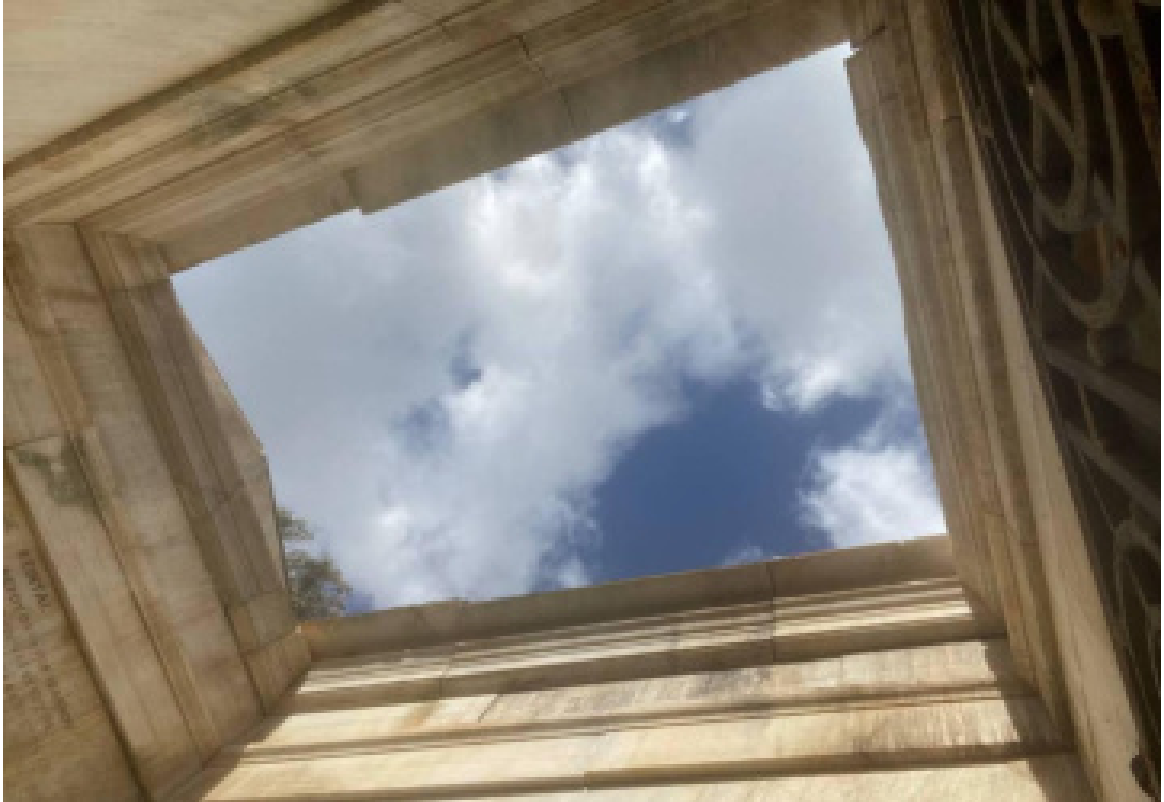
Φωτ. 21. Η ανωδομή του μνημείου μετά την κατάρρευση της στέγης που προήλθε από τα ακραία καιρικά φαινόμενα στις 23/2/2022
