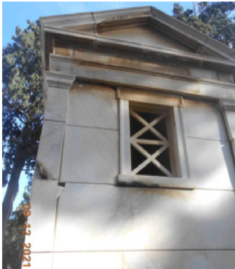
Φωτ. 7. Κατακερματισμένη παραστάδα στην βορειοδυτική πλευρά του μνημείου . Διακρίνεται η διάνοιξη των αρμών στο καταέτιο γείσο.
