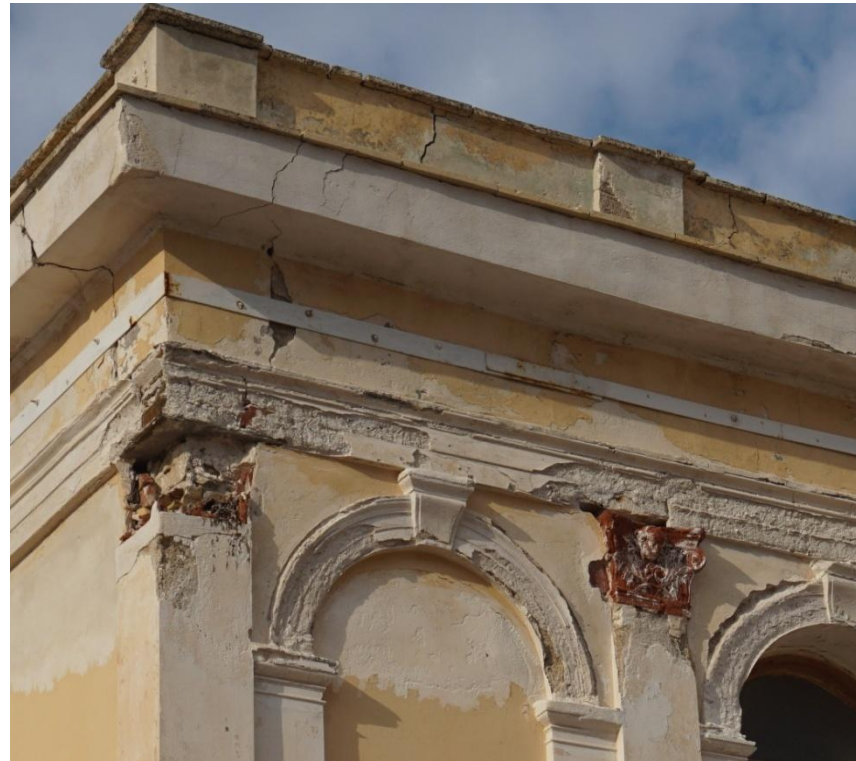
Εικ. 132: Αποσαθρώσεις - ρωγμές στις απολήξεις των πύργων - απώλεια γωνιακού επίκρανου
