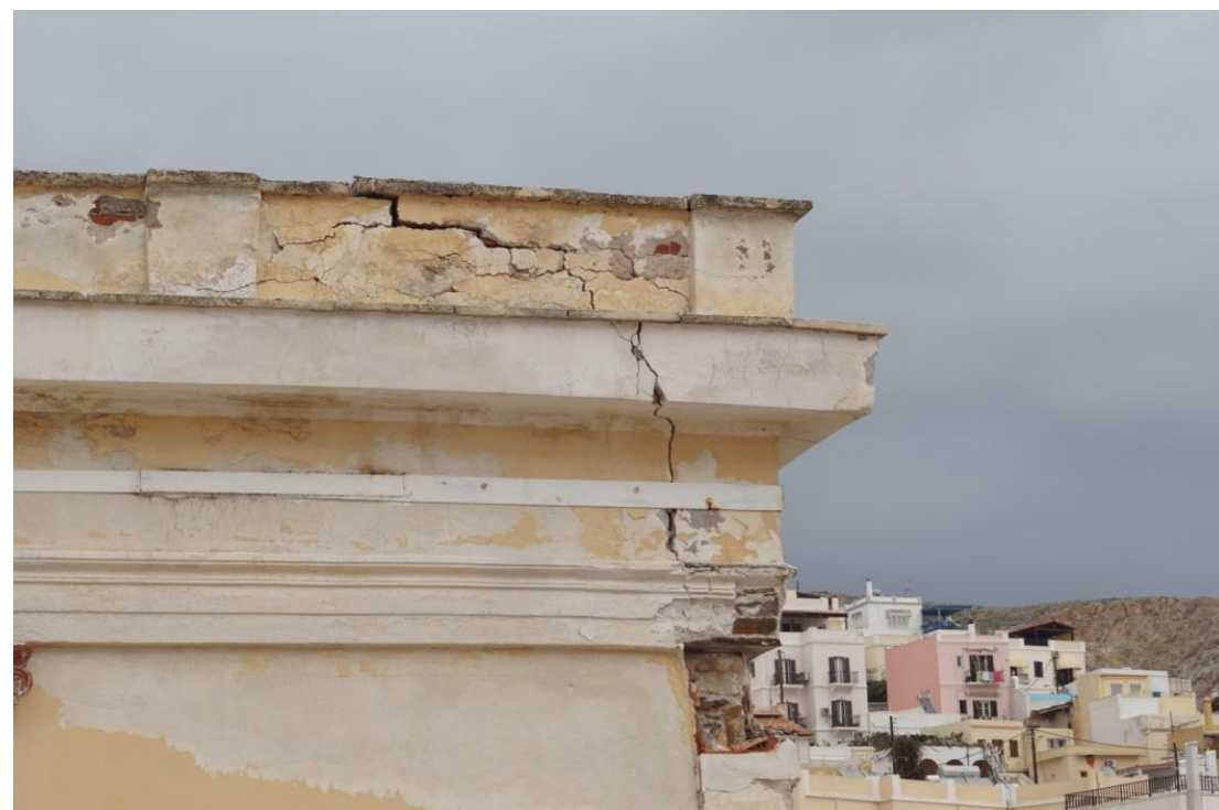
Εικ. 156: Εκτεταμένες υγρασίες και ρηγματώση και λόγω απώλειας στήριξης
