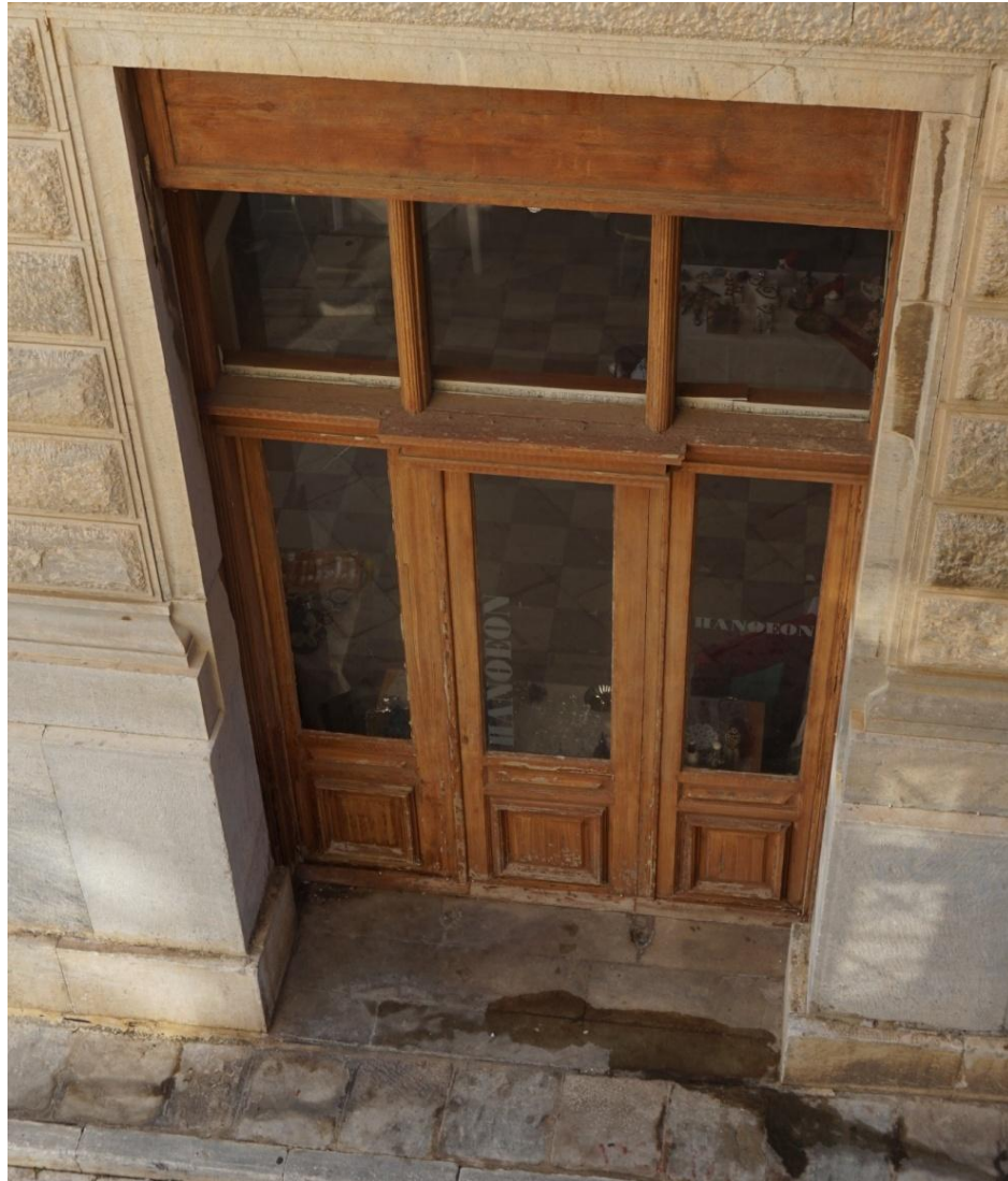
Εικ. 148: Κουφώμα που διατηρείται σε καλή εν γένει κατάσταση με εξαίρεση το κατοκάσι.
