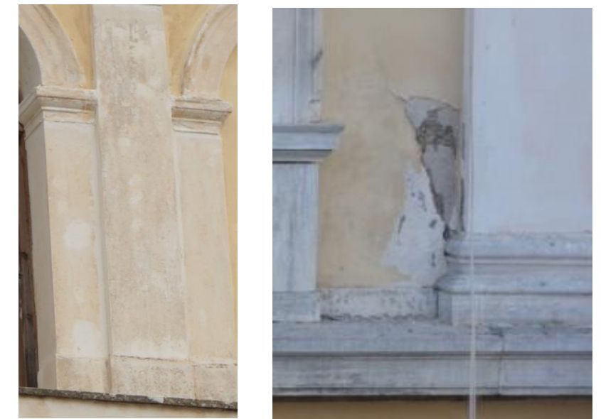
Εικ. 112: Αποσάθρωση κονιαμάτων
