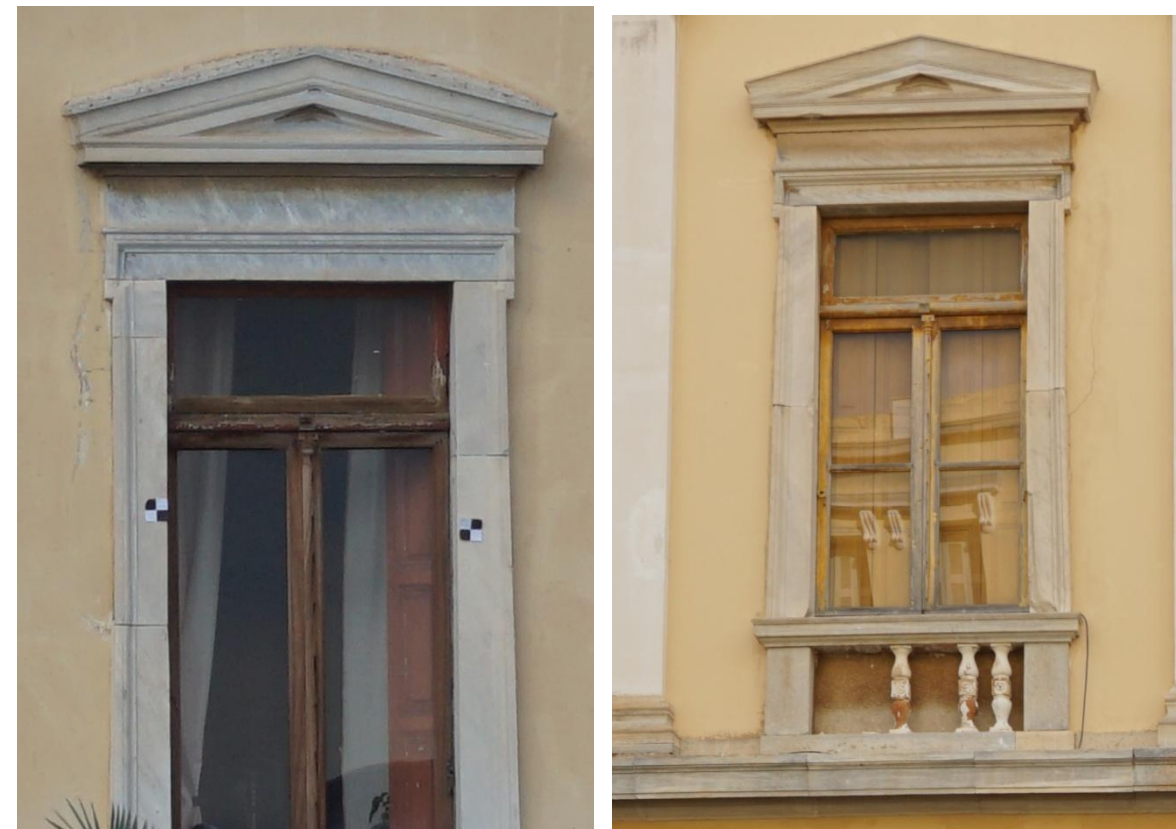
Εικ.163-164: Ρηγματώσεις περιμετρικά των κορνιζωμάτων ανοιγμάτων. Αριστερά άνοιγμα της νότιας όψης. Δεξιά άνοιγμα της βόρειας όψης.
