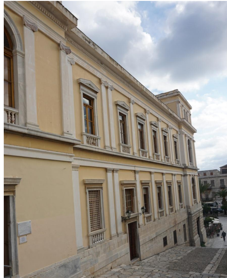
Εικ. 109: Οι κύριες φθορές εντοπίζονται στο γείσο του δώματος
