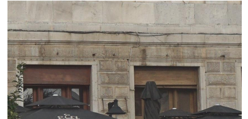
Εικ. 58 Ανάρτηση δικτύων στη νότια όψη
