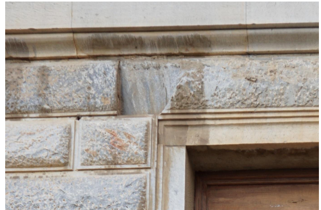
Εικ. 71 Απόλεια μάζας και χρωματικές αλλοιώσεις σε τμήμα της ισόδομης τοιχοποιίας ισογείου
