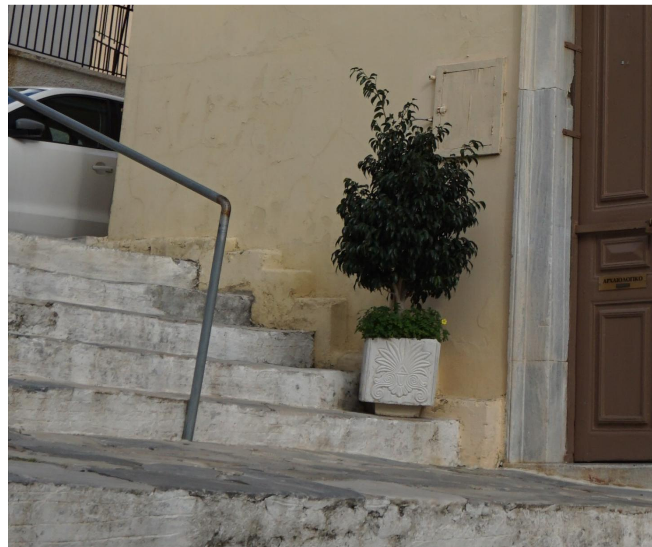
Εικ.167: Ίχνη ανερχόμενης υγρασίας στη βορειοδυτική γωνία του κτιρίου, η οποία πιθανόν προκλήθηκε από τη μεταγενέστερη ίσως διαμόρφωση της κλίμακας σε επαφή με το κτίριο, σε ανώτερη στάθμη συγκριτικά με την αρχική.
