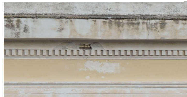
Εικ. 113: Βιογενής κρούστα κατά μήκος του γείσου και αποκολλήσεις
