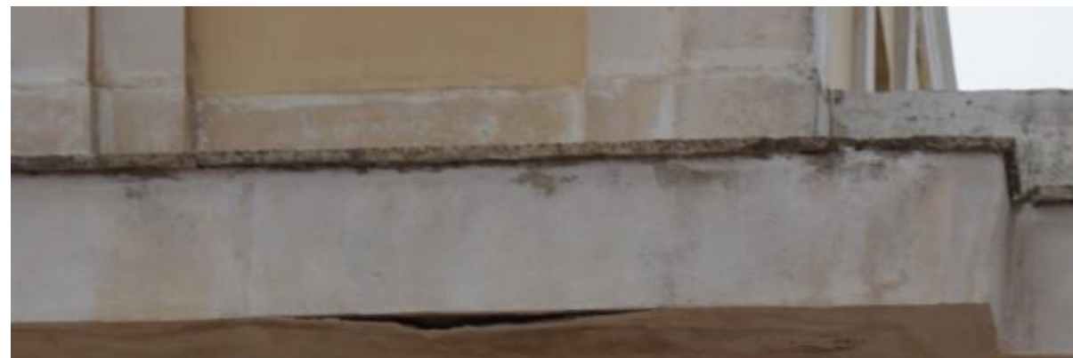
Εικ. 135: Αποκόλληση λόγω υγρασίας
