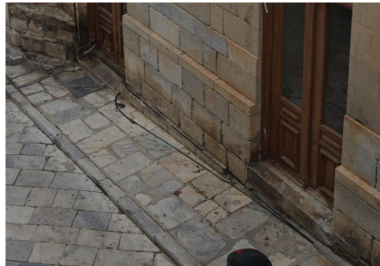
Εικ. 140: Επικαθήσεις και απόλεια κονιάματος δομής
