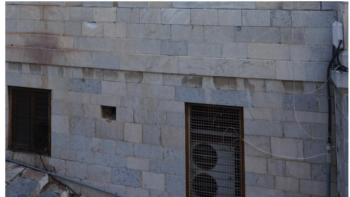
Εικ. 124: Επικαθήσεις - θραυσμένα μέρη στη βάση της τοιχοποιίας
