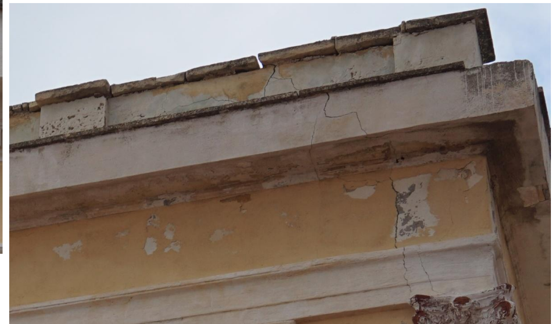
Εικ. 134: Αποσαθρώσεις - ρωγμές στις απολήξεις των πύργων
