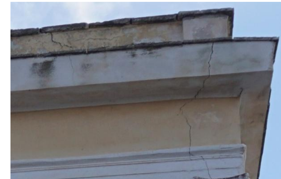
Εικ. 115: Ρωγμές και αποσάθρωση κονιάματος στις γωνίες των πύργων
