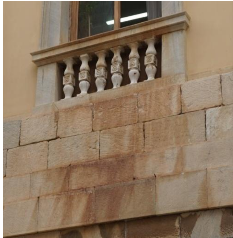
Εικ. 139: Επικαθήσεις και απόλεια κονιάματος δομής
