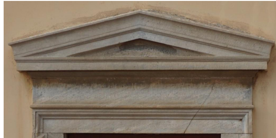
Εικ. 142: Επικαθήσεις και φθορές στη σύνδεση με την τοιχοποιία
