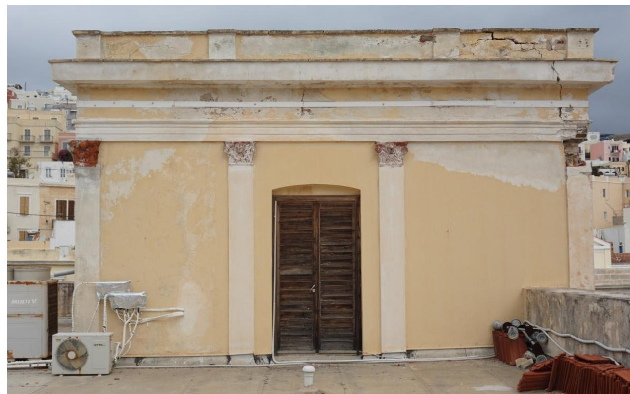
Εικ. 154 έως 155: Κατακόρυφη ρωγμή στη περιοχή των γωνιών - εκτεταμένη αποδιοργάνωση των κονιαμάτων στις εσωτερικές όψεις του βορειοανατολικού πύργου
