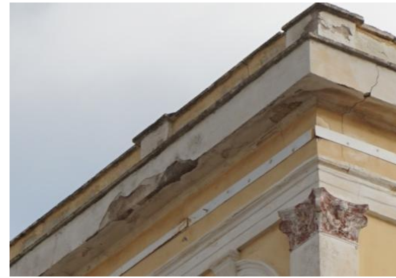
Εικ. 79: Εκτεταμένη αποσάθρωση και ρωγμές στον πύργο.
