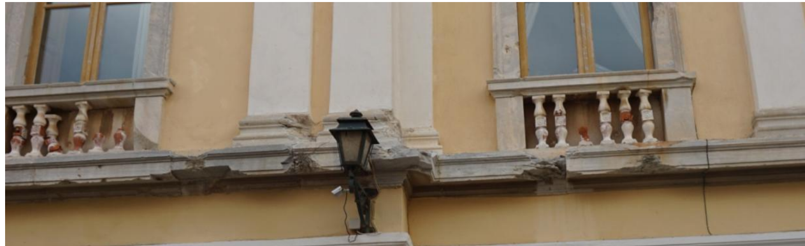
Εικ. 90: Απόλεια επιχρίσματος μπαλούστρων και απουσία τμημάτων
