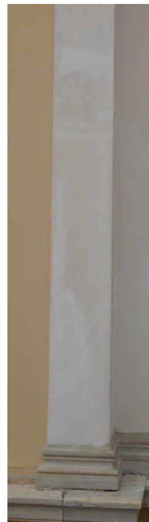
Εικ. 137: Χρωματικές αλλοιώσεις λόγω προγενέστερων επισκευών
