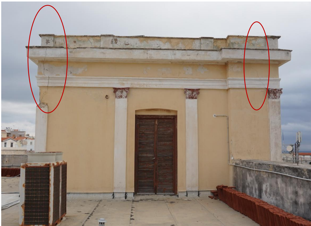
Εικ. 1-3 Ενδεικτικές ρηγματώσεις – αρχικό στάδιο αποκόλλησης των γωνιακών τμημάτων των λιθοδομών
