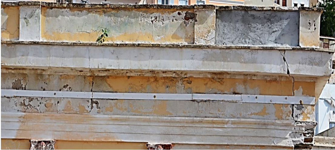
Εικ. 10 Απώλεια κονιάματος- Ρωγμές
