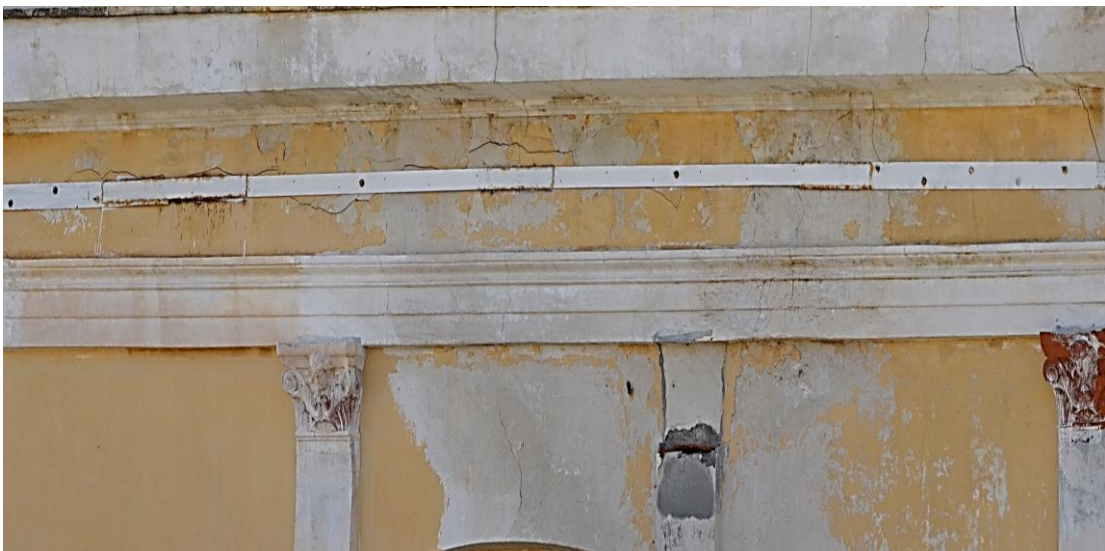
Εικ.9 Απώλεια κονιάματος- Ρωγμές
