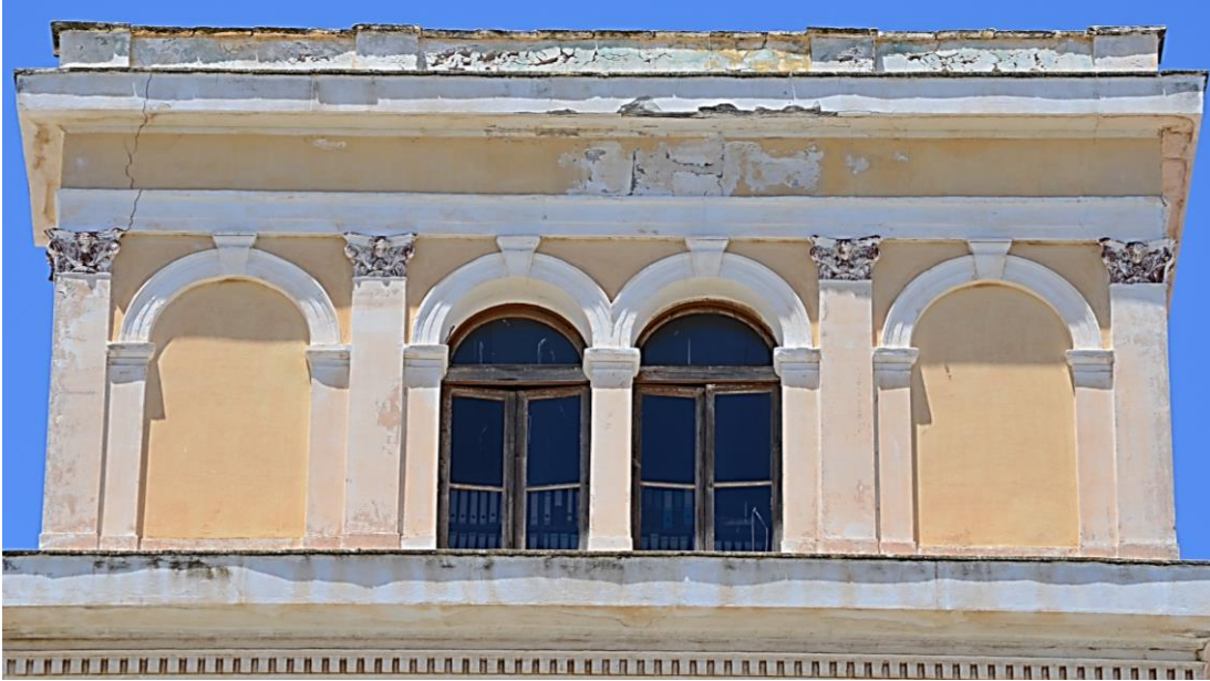
Εικ.12 Απώλειες κονιάματος- Αποκολλήσεις- Ρωγμές
